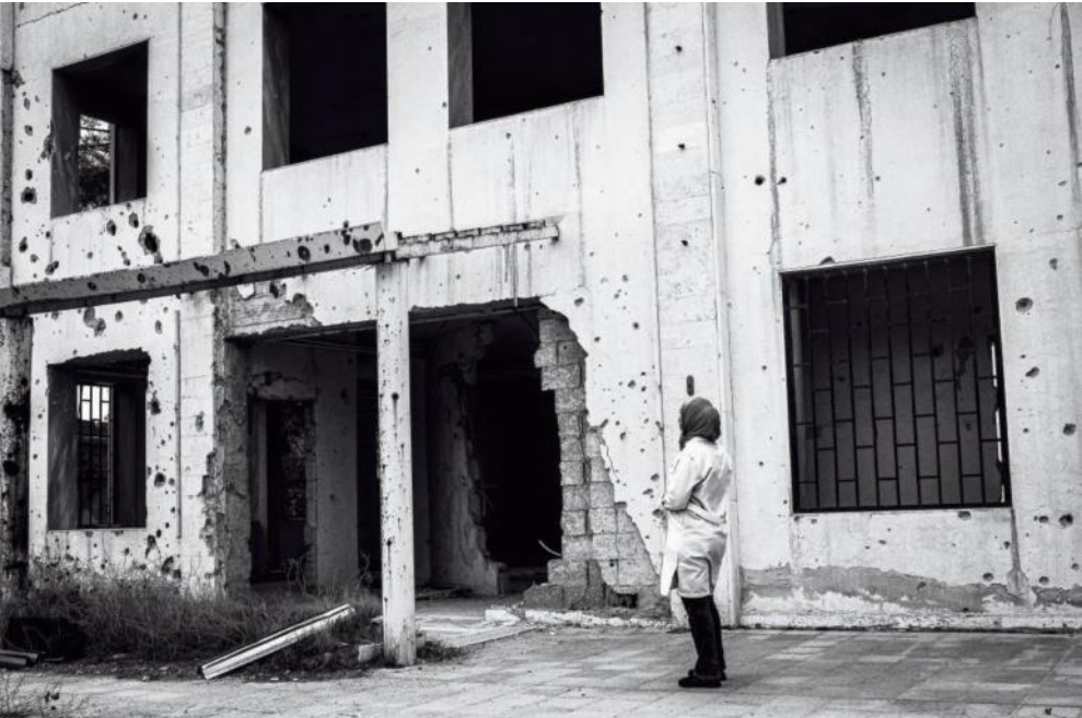
Gebouwen van het Ibn Sina ziekenhuis zijn beschadigd in de oorlog .
