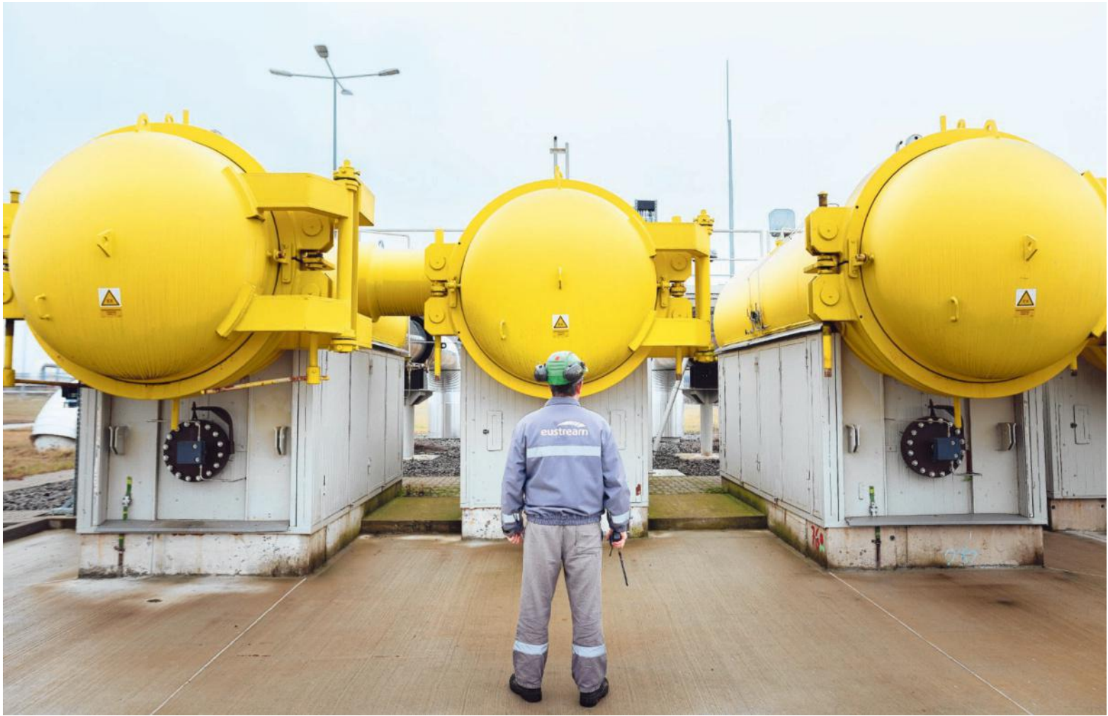
De Eustream gasinstallatie in Slowakije. Hier kwam via Oekraïne Russisch gas binnen, totdat Oekraïne dit vanwege de oorlog stopte. FOTO ROBERT NEMETI/GETTY
