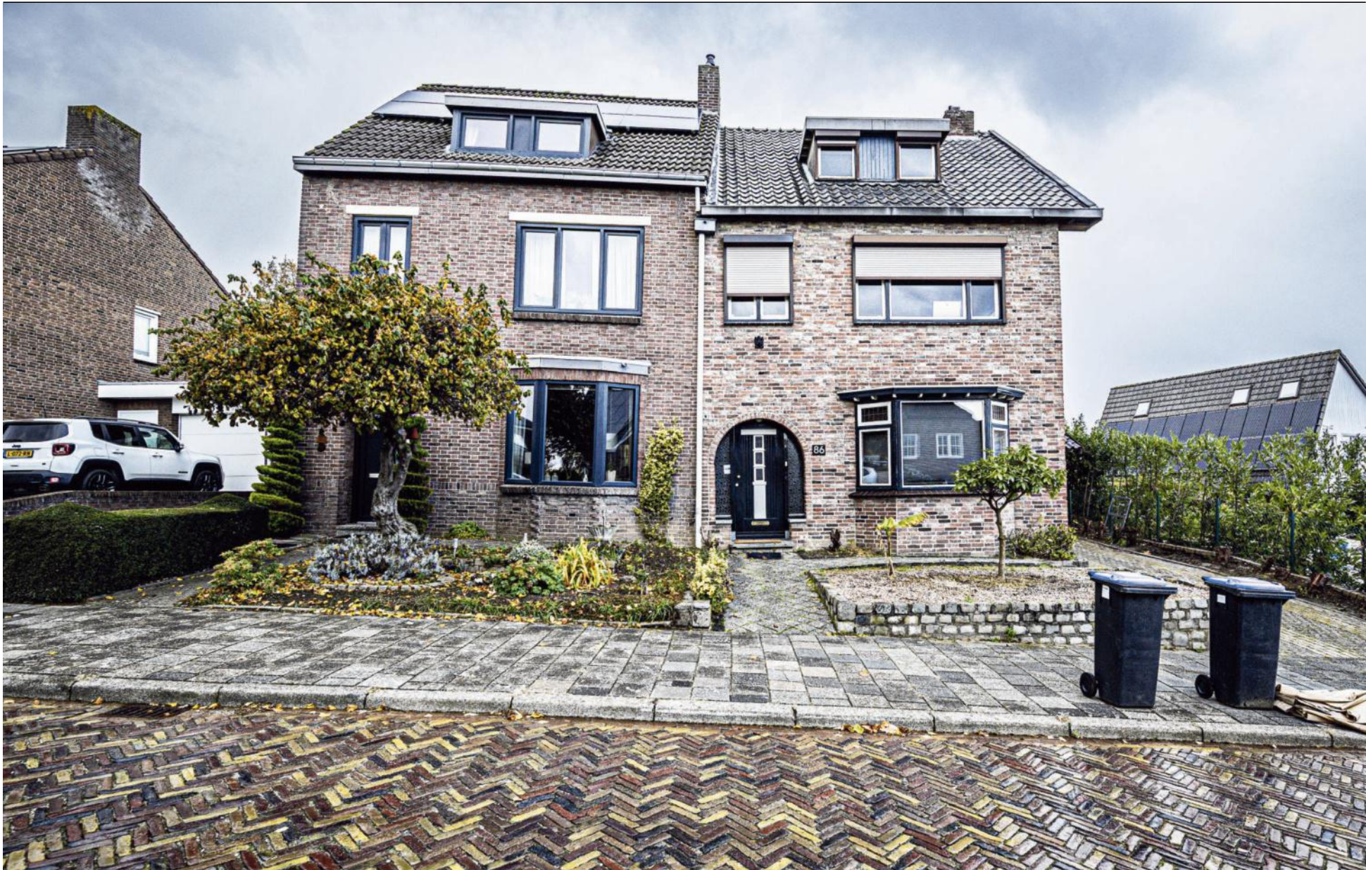
In de Dr. Clemens Meulemanstraat in Heerlen is de geleden schade door mijnbouw in Limburg goed zichtbaar. Huizen zijn ernstig verzakt. Het huis op links leunt tegen het huis van de bure. Binnen is alles waterpas verbouwd. De eigenaar gaat zijn schade melden bij het nieuwe mijnschadeloket. FOTO ROGER DOHMEN / ANP
