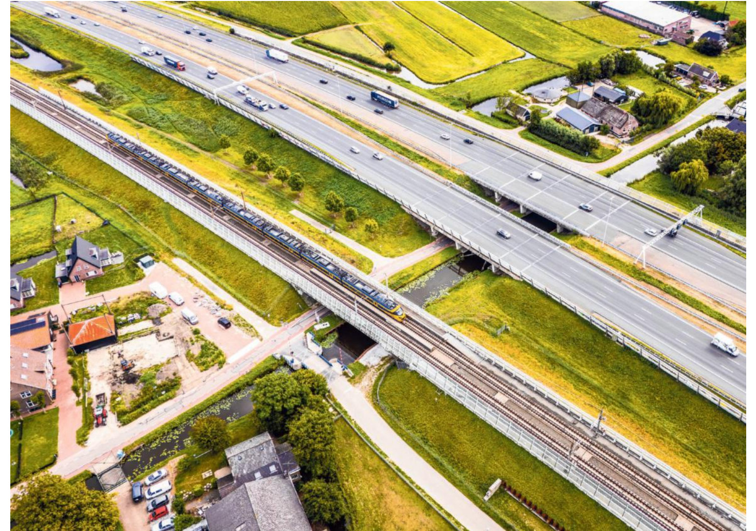
Het HSL-viaduct bij Rijpwetering . ProRail gaat de constructie ervan verbeteren en de spoorbaan verstevigen. In stalen onderdelen van het viaduct zijn scheurtjes ontstaan. FOTO ANP
