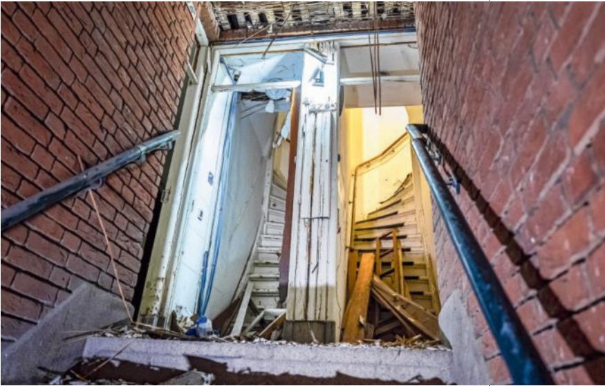
Explosieschade in een portiek in Rotterdam, januari 2025. FOTO ANP
