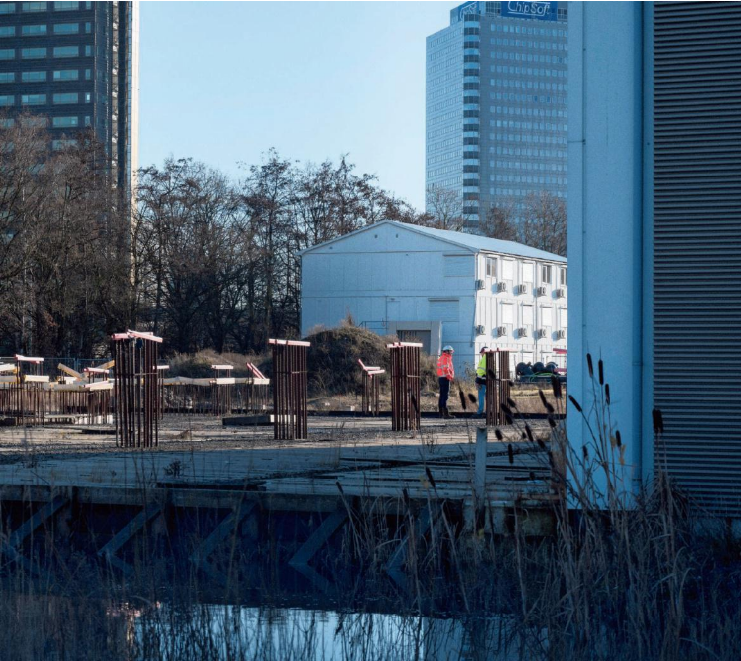
Datacenter Unica, in Amsterdam Nieuw-West. De drie nieuwe datatoren komen in het Westelijk Havengebied. FOTO ZARA NOR
