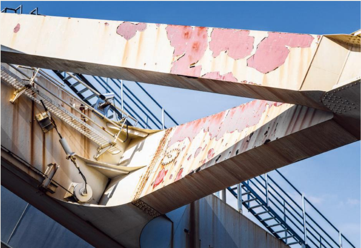
Verf laat los op de Van Brienenoordbrug. Gemeenten hebben voor „noodzakelijke investeringen” in onder meer infrastructuur geen of te weinig middelen in de begroting opgenomen. FOTO JEFFREY GROENEWEG / ANP
