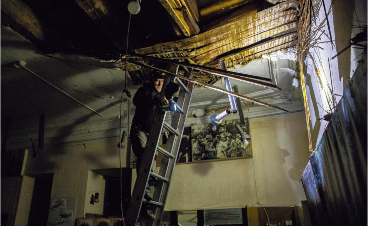
Een medewerker van het museum in Cherson checkt het dak dat onlangs is beschadigd door een Russische aanval.
