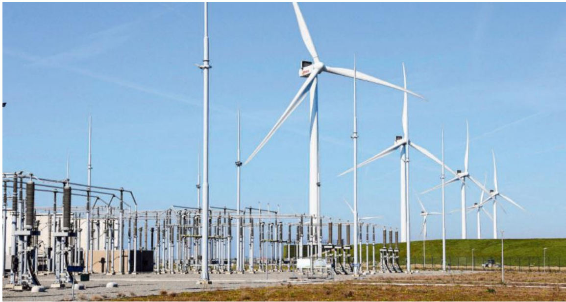
Een elektriciteitsstation van Tennet op de Rotterdamse Maasvlakte. FOTO PIROSKHA VAN DE WOUW/REUTERS
