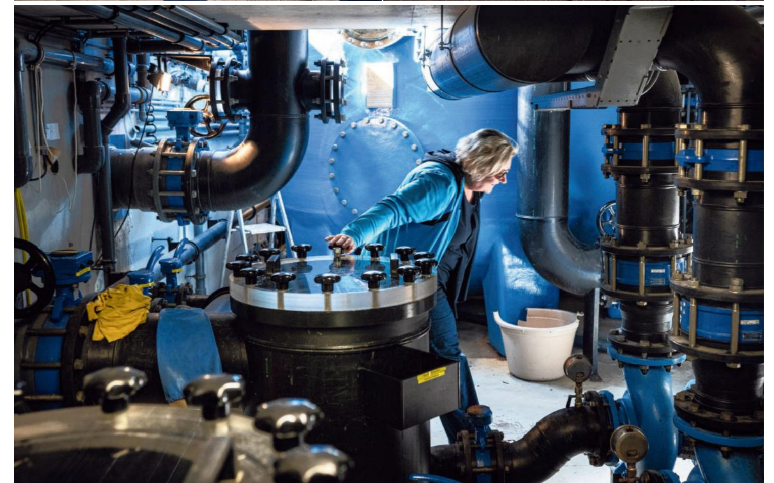
Zwembad de Leemdobben is het hele jaar open. Onder: installaties van het zwembad, met medewerker Trea Rutgers.
