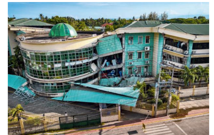
Het gebouw van de Notre Dame of Dadiangas University in General Santos is ingestort. FOTO EZRA ACAYAN/GETTY IMAGES
